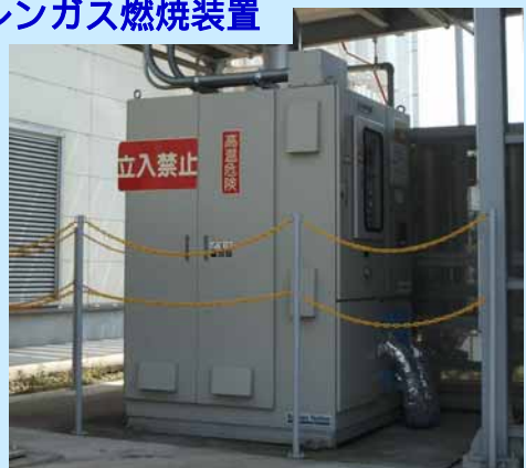
酸化エチレンガス燃焼装置
